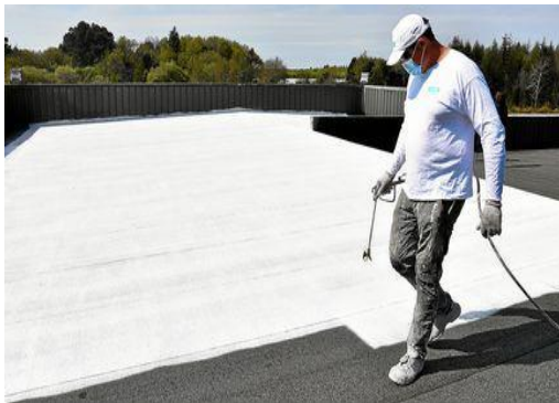
Un homme peint en blanc un toit à l'aide d'une peinture réfléchissante (Morbihan).
