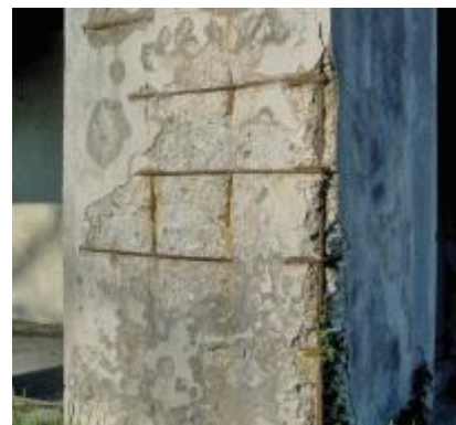
Phénomène de corrosion d'un pilier en béton
