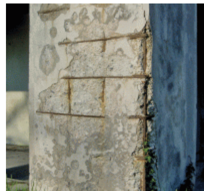
Phénomène de corrosion d'un pilier en béton
