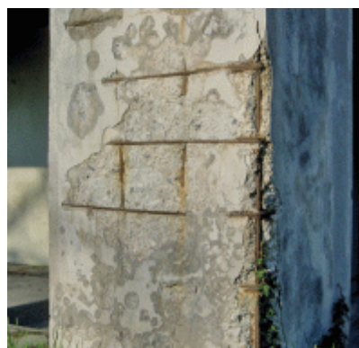
Phénomène de corrosion d'un pilier en béton
